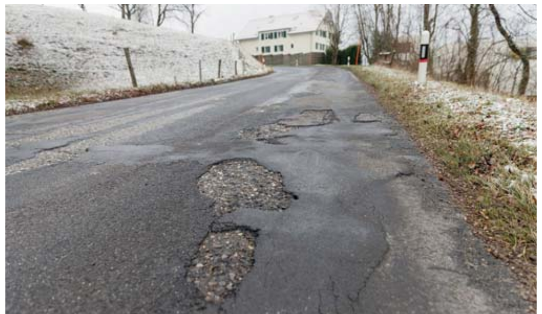
La chaussée de la route de Bassins et du chemin du Châtelard est bien endommagée. SIGFREDO HARO
